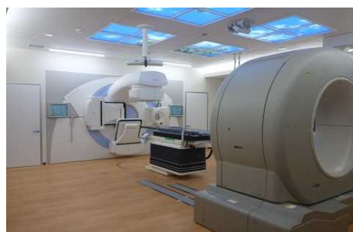
＜先端医学棟 1階 放射線治療室＞
